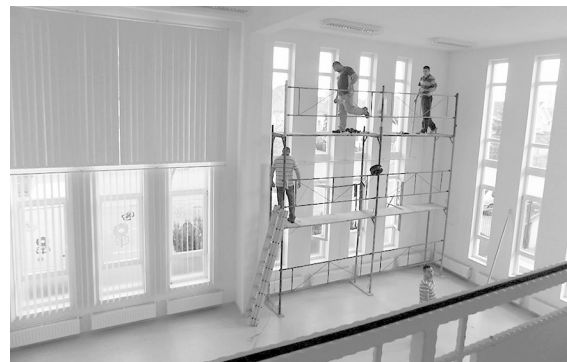
A tornaterem árnyékolásával nagy gond oldódott meg az óvodában
